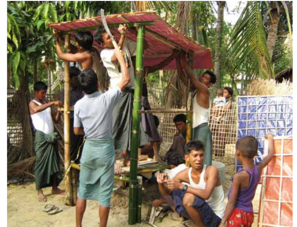
Unter Anleitung der Malteser bauen die Dorfbewohner die Latrinen für die Familien sowie für Schulen und weitere öffentliche Einrichtungen.
